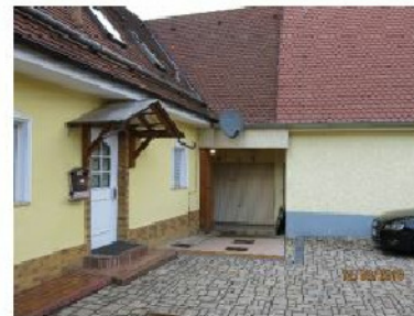
Störende nicht Materialkonforme An- und Einbauten im Ensemble Vordach, Kunststofftüre, Fensterfaschen Gliederungen
